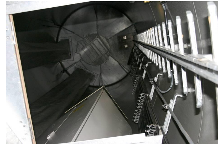
Photo 31 : Intérieur du mât d'une éolienne (échelle d'accès) © ALISE
