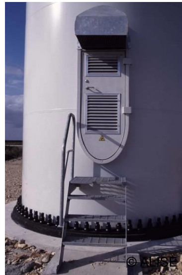
Photo 35 : Transformateur électrique intégré au mât de l'éolienne
